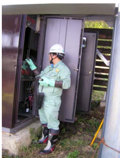
電気設備点検
