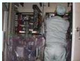
制御盤の更新
